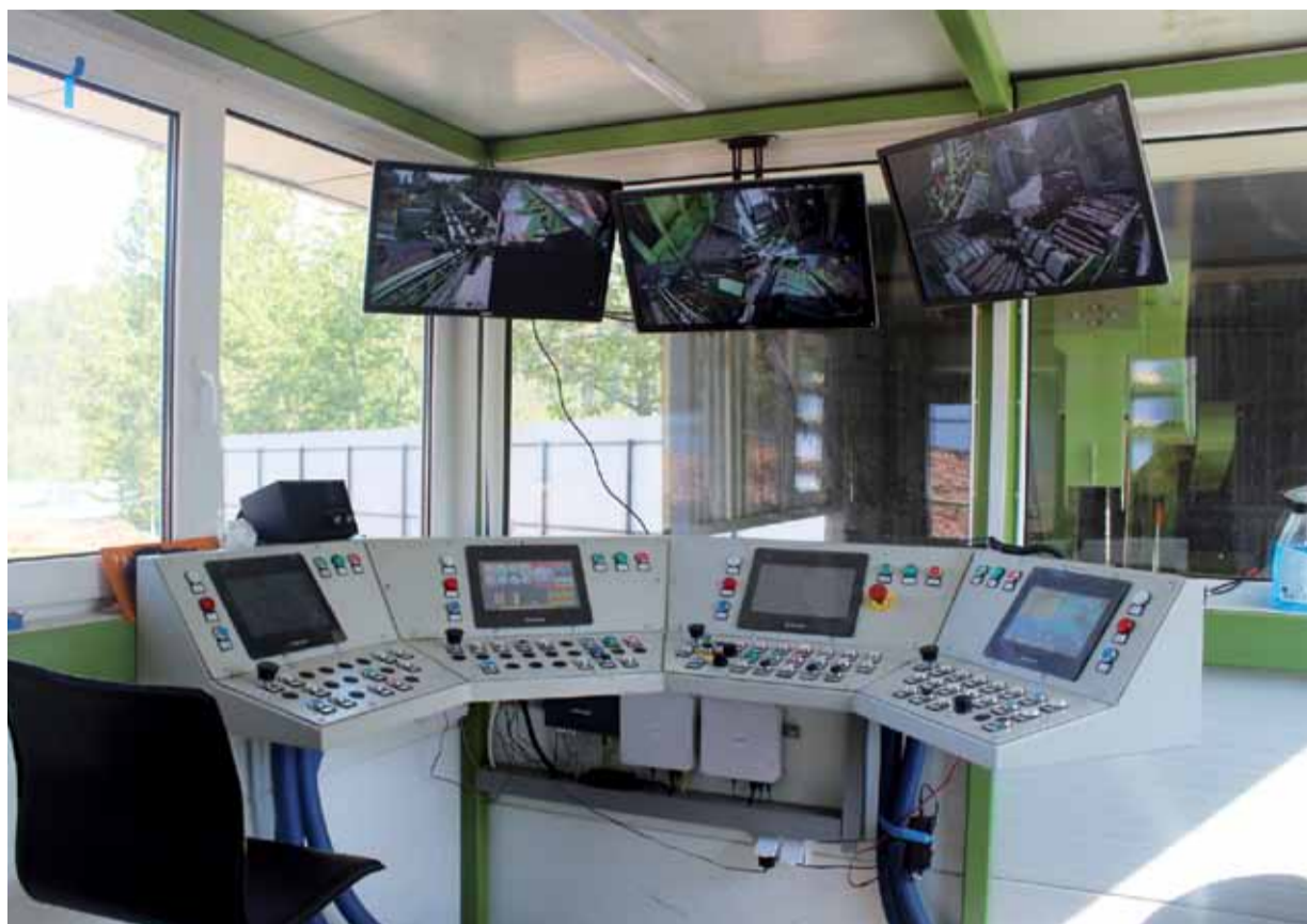
Linia wyposażona jest w całoroczną kabinę operatora, o konstrukcji stalowej, wyposażoną w instalacje elektryczne, szafę sterowniczą, pulpit sterowniczy, ogrzewanie i oświetlenie.
