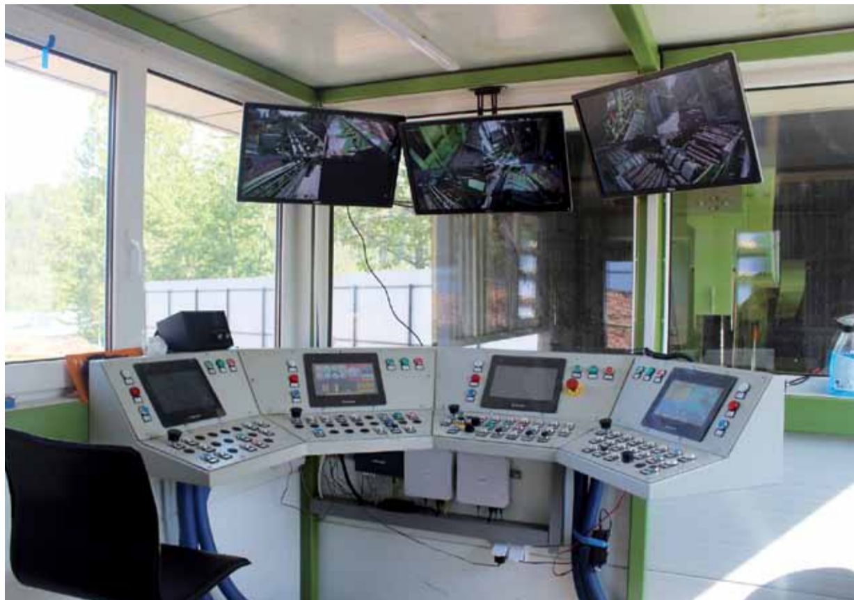
Linia wyposażona jest w całoroczną kabinę operatora, o konstrukcji stalowej, wyposażoną w instalacje elektryczne, szafę sterowniczą, pulpit sterowniczy, ogrzewanie i oświetlenie.
